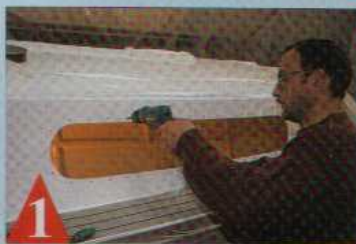
1 Après une nouvelle peinture... mieux vaut repercer les trous de vis au bon diamètre.
