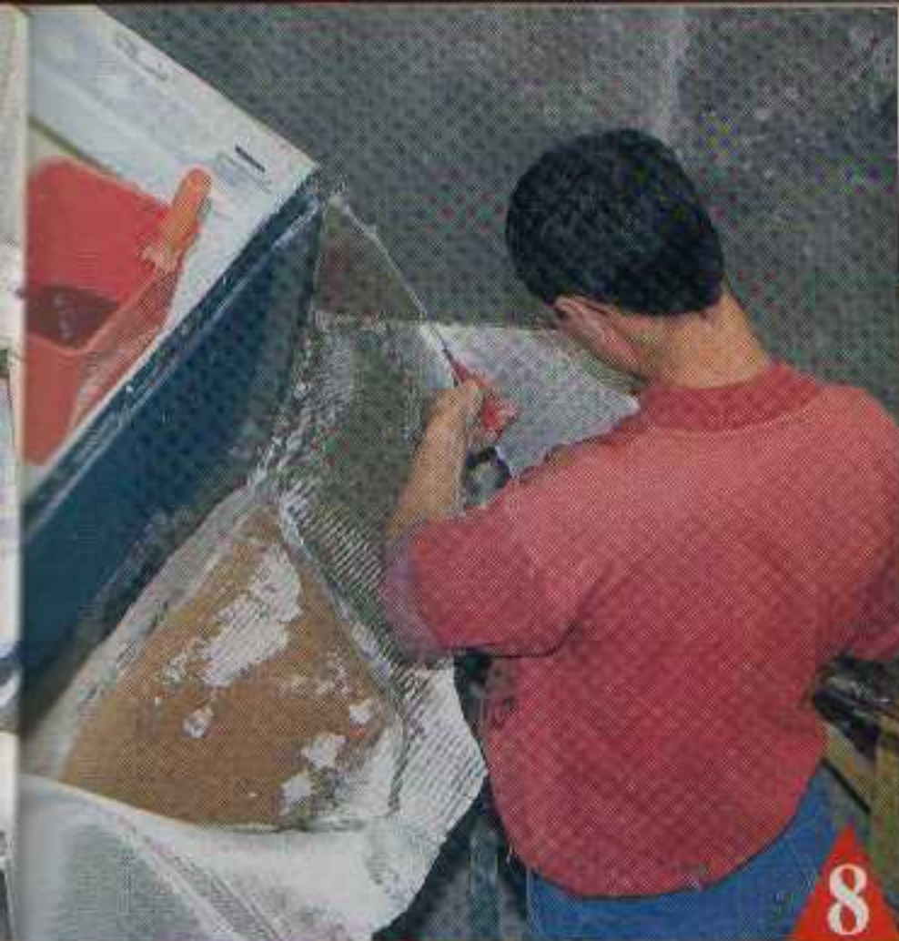
Deux tissus mat de verre et deux rovings seront appliqués alternativement. La pose n'est pas facilitée par les formes qui ne sont pas développables et imposent des découpes.
