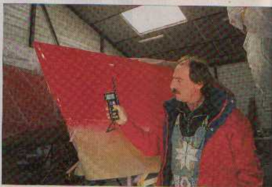
Christian Marbach est formel : un contrôle sérieux de la température et de la limite du point de rosée est primordial.
